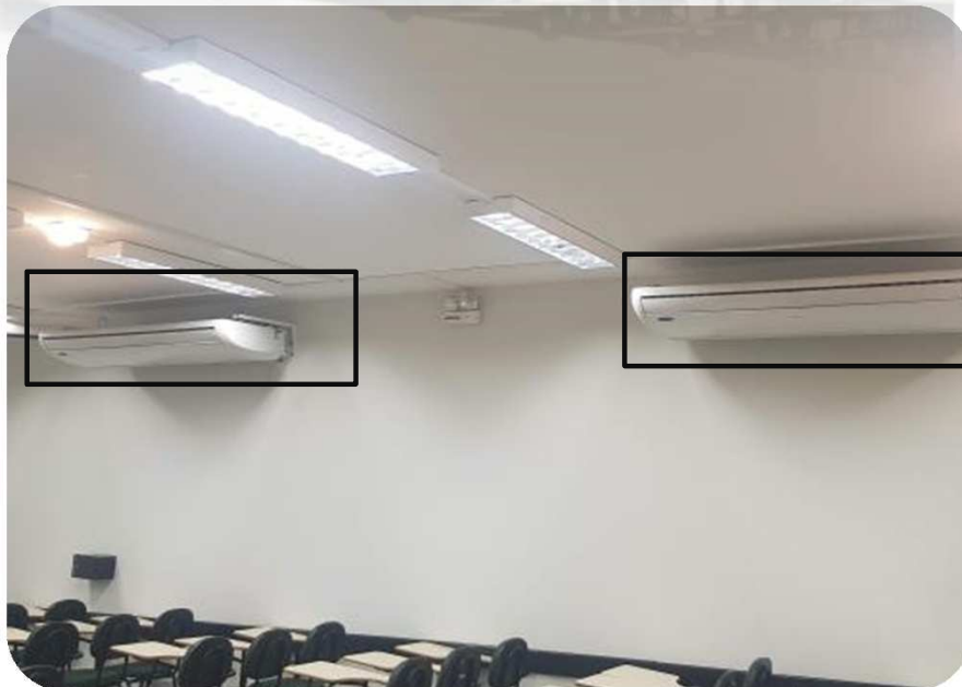
FOTO 2 : DETALHE DOS DOIS SPLITS INSTALADOS NA SALA DE AULA FA-15.
