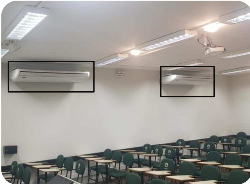
FOTO 1 : DETALHE DOS DOIS SPLITS INSTALADOS NA SALA DE AULA FA-15.
