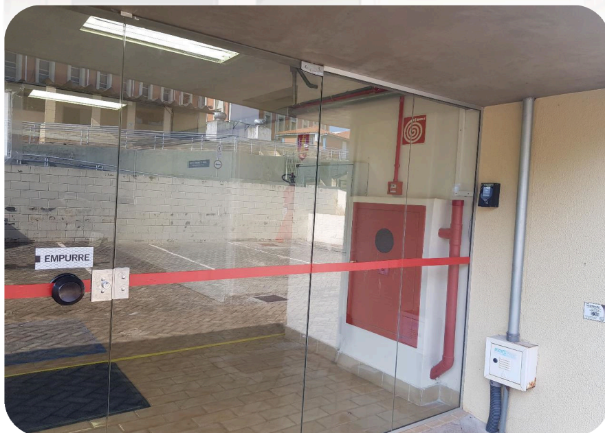
FOTO 1: FOTO DA PORTA DO PRÉDIO DO LPI COM O SISTEMA DE CONTROLE DE ACESSO.
