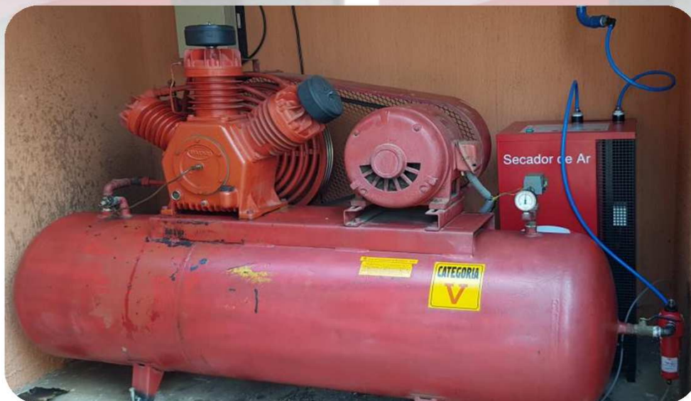
FOTO 3: Detalhe do sistema de secagem de ar comprimido instalado junto ao compressor.
