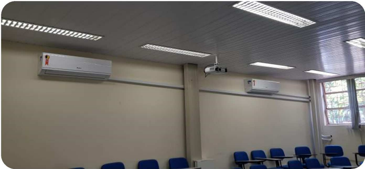
FOTO 1 E 2: Detalhe dos Splits instalados no Anfiteatro I do DTA/FEA.
