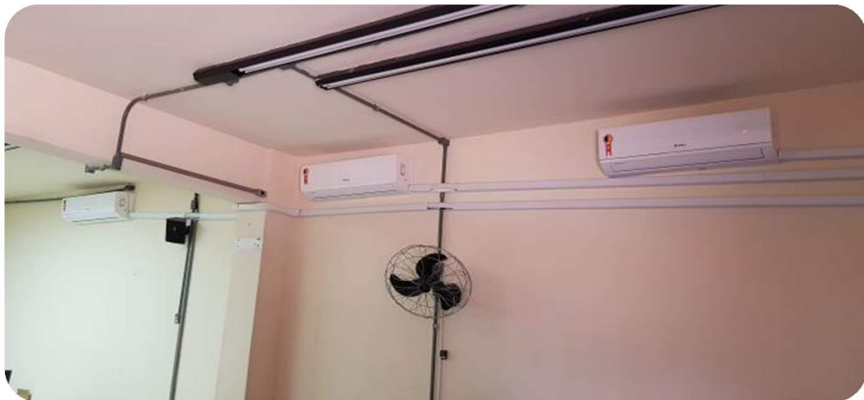
FOTO 3 E 4: Detalhe dos Splits instalados no Anfiteatro II do DTA/FEA.
